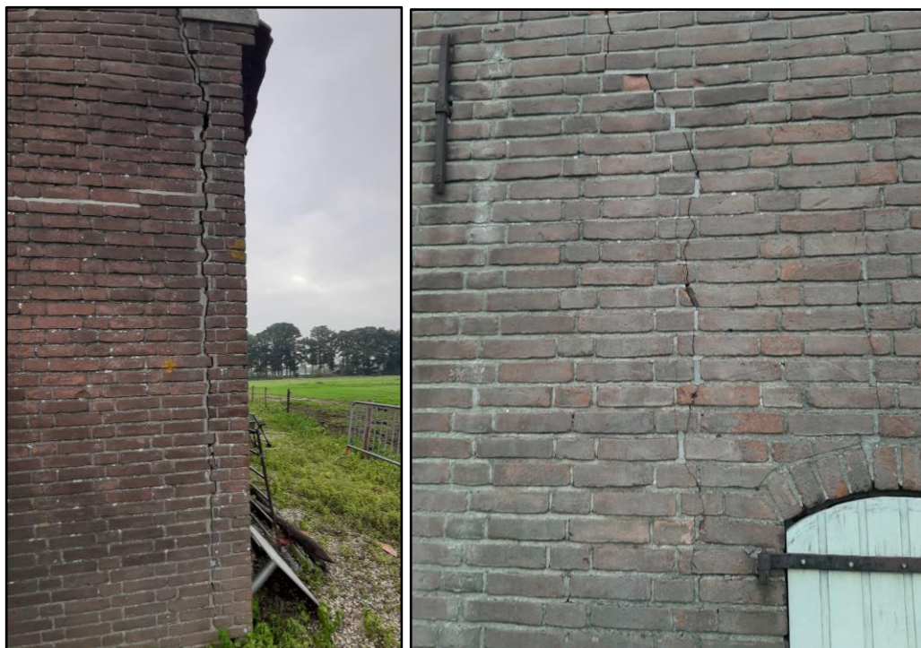
Figuur 3 Scheuren in de muren van de te transformeren schuur.
