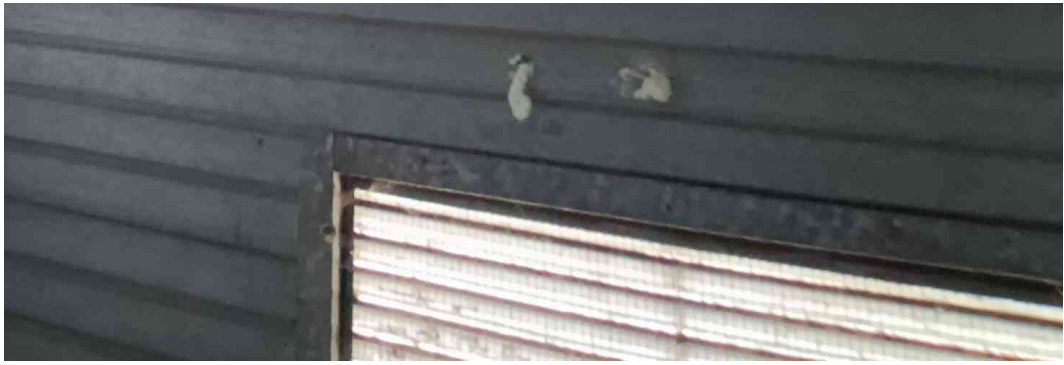
Figuur 5.6. Met fijn gaas afgedichte ventilatieopeningen
