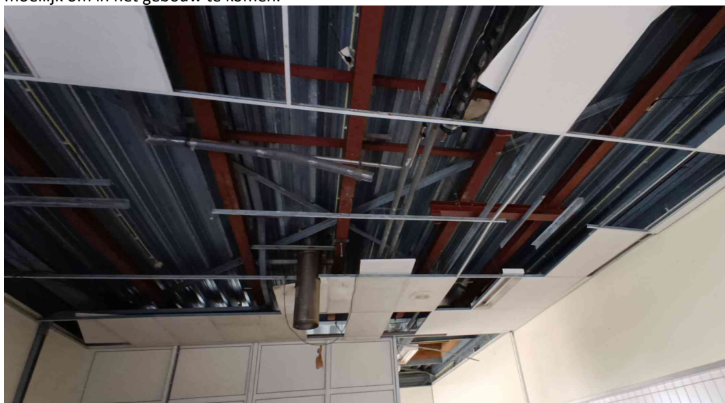
Figuur 5.9. Onderzoek plafonds Kraanvogelstraat 15 a
