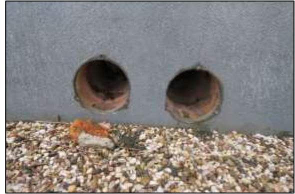
Foto 15. Openingen onderin muur van woonhuis
