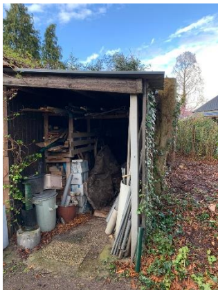
Figuur 12: Asbestverdacht materiaal
