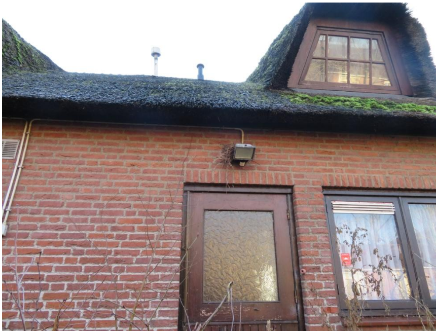
Fig. 11.: Vermoedelijk nest van een houtduif boven de verklikkerlamp boven de achterdeur van de woning
