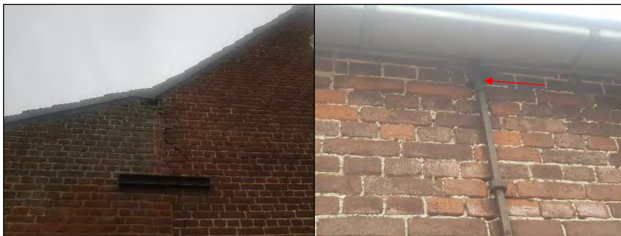
Afbeelding 5: Opening en scheur in gevel (links) en opening naast haak, aangeven met rode pijl (rechts).
