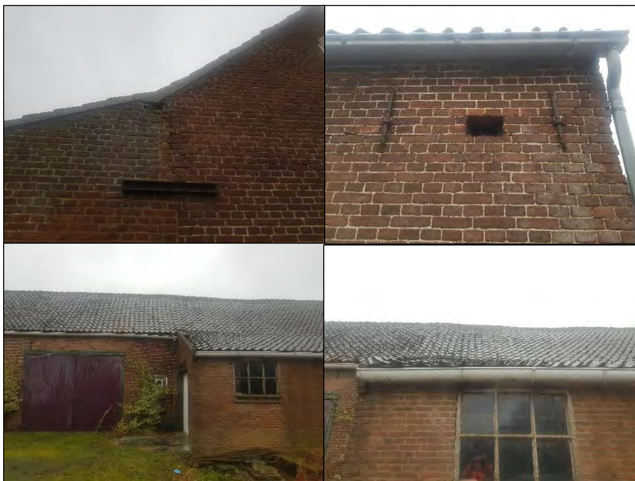
Afbeelding 2: Scheur en opening in gevel (linksboven), kapot ventilatierooster (rechtsboven), pannendak van de schuur (linksonder) en ruimte onder eerste rij dakpannen (rechtsonder).
