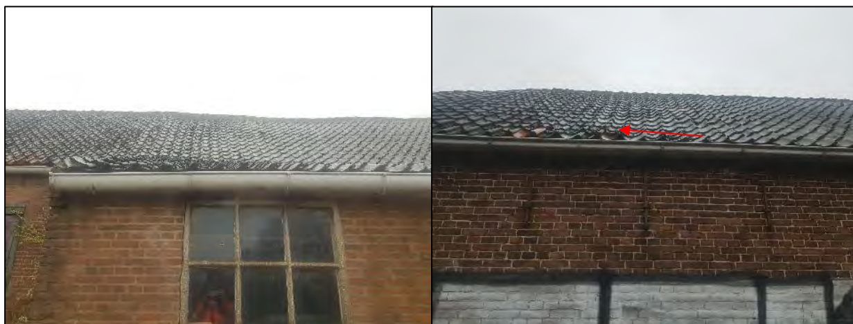
Afbeelding 4: Ruimte in onderste rij dakpannen (links) en enkele kapotte en scheefliggende pannen, aangeven met rode pijl (rechts).
