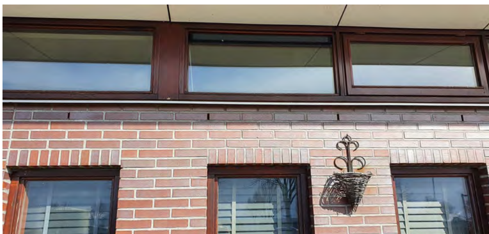
In de bakstenen buitenmuren bevinden zich veel open stootvoegen. Foto: K. de Vries | Ecoresult B.V.
