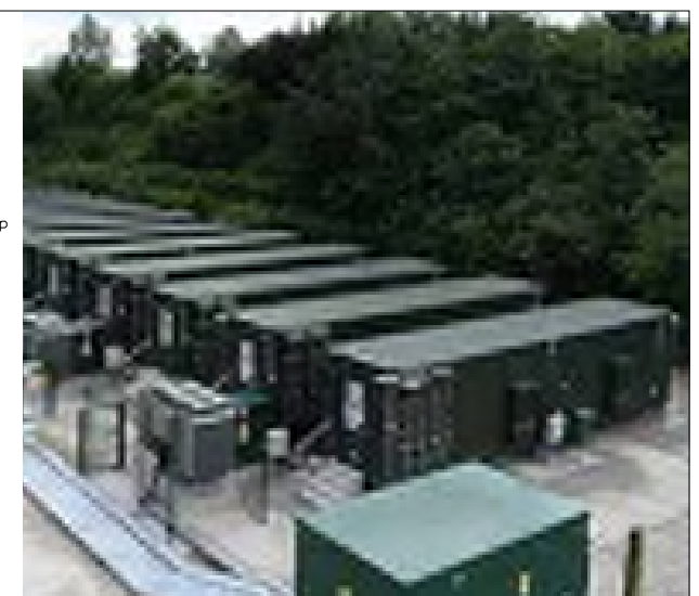
afb. 40: opstelling batterijen (www)
