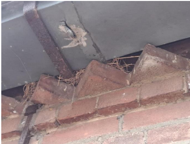
Vogels kunnen een nestplaats bezetten in de openingen tussen de dakgoot en de buitengevels van de bedrijfswoning.
