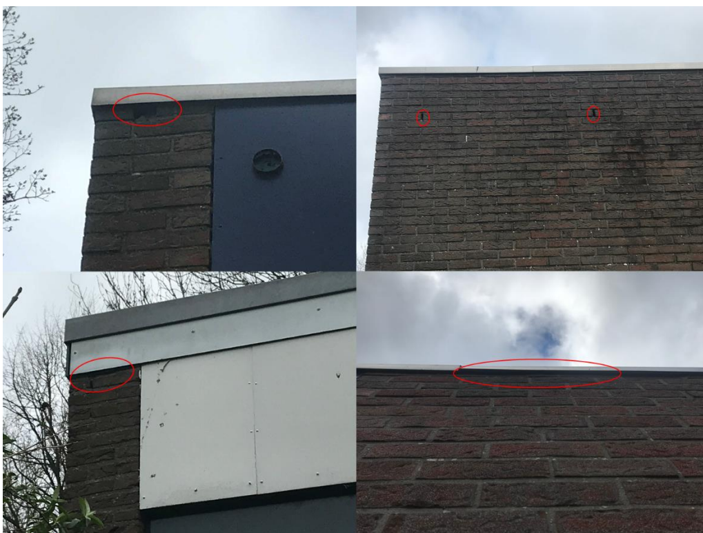
Figuur 4 Een aantal potentiële invliegopeningen in de bebouwing op de planlocatie. Door de aanwezigheid van deze openingen kunnen vaste rust- en/of verblijfplaatsen van vleermuizen niet worden uitgesloten.
