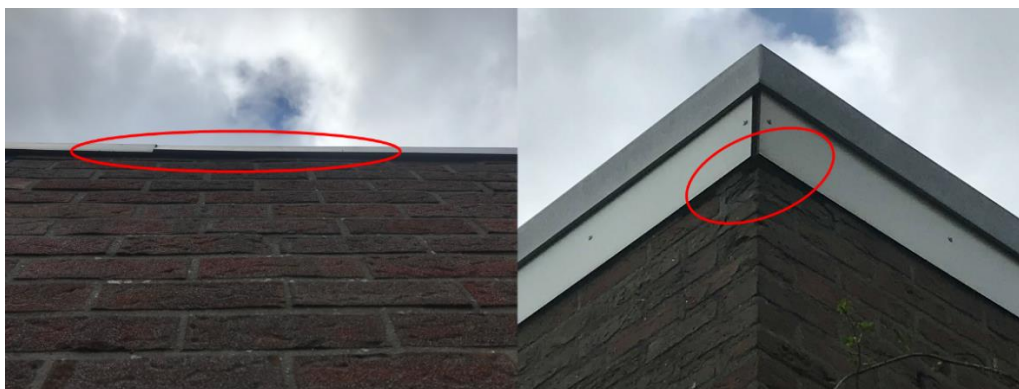
Figuur 2 Potentiële invliegopeningen zoals kierende daklijsten (links) en openingen onder de trespaplaten (rechts).
