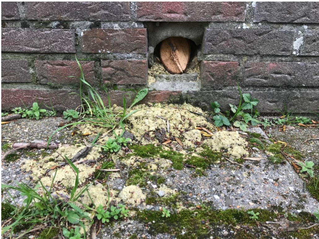
Figuur 2 De muren zijn mogelijk (plaatslijk) geïsoleerd. Echter kunnen vleermuizen ook toegang krijgen tot de ruimte onder het dak, waardoor vleermuisverblijfplaatsen niet uit te sluiten zijn.
