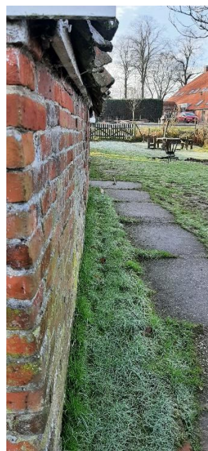
Iets hellend metselwerk
