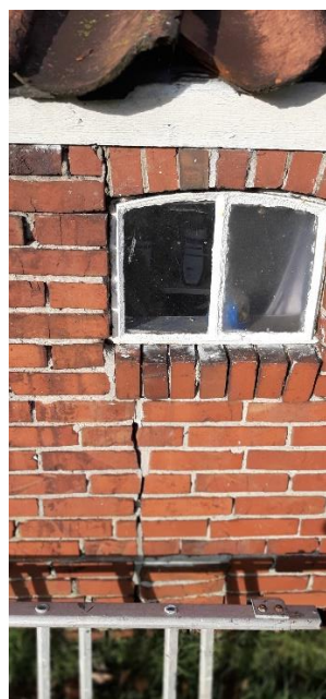
Scheurvorming vanuit gietijzeren raam
