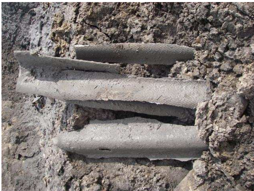
Foto 5: Kleinschalige asbestvondst op baggerdepot te Veendam
