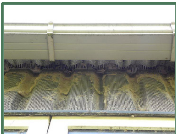
Roosters en vogelschroot onder het dak van de noordelijke stal
