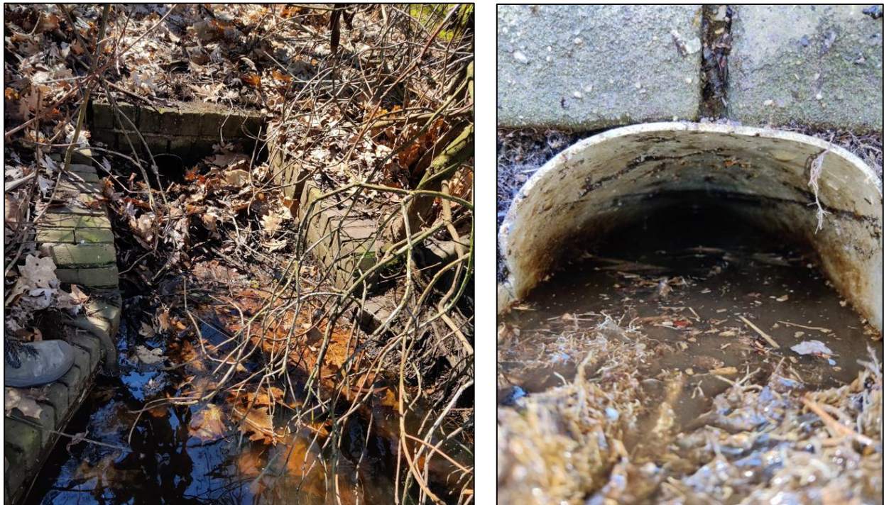
Afbeelding 8: Waargenomen in-/uitlaatconstructie centraal gelegen 's-Heerenven
