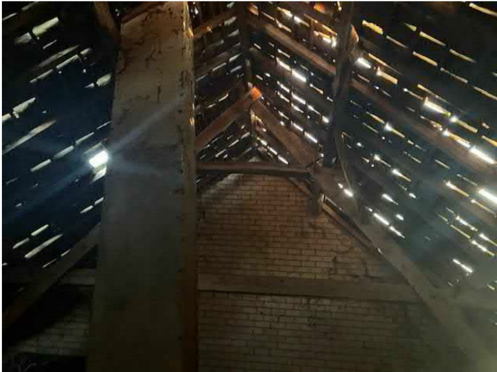
• Afbeelding 8: onderzijde van het dak van het achterhuis, dakpannen zonder dakbeschoot
