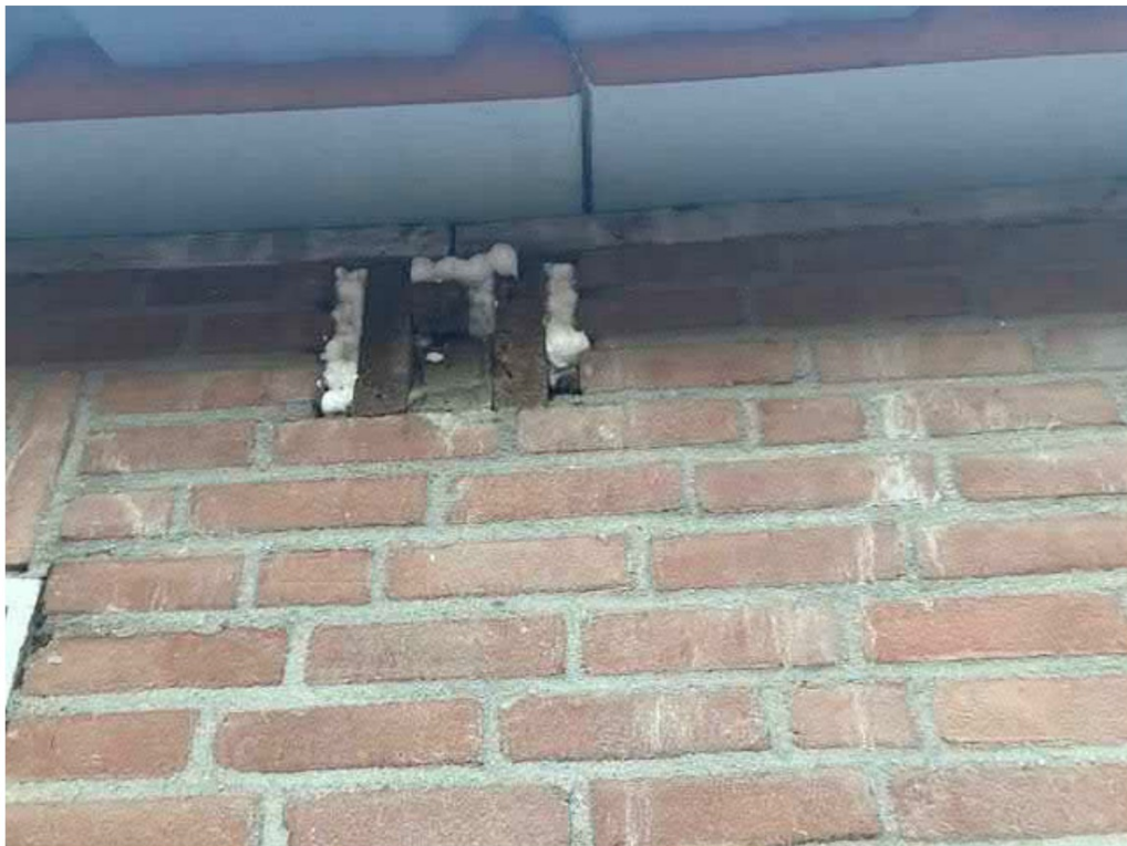
• Afbeelding 24: gaten in de gevel dicht gepurd om kauwen te weren
