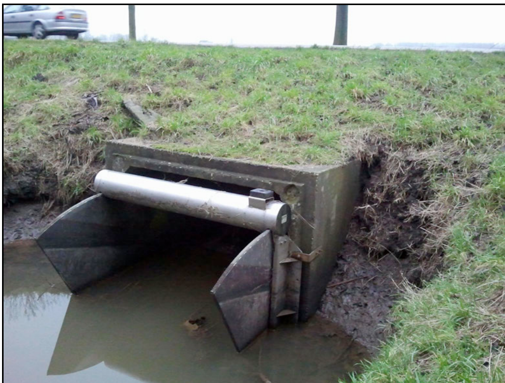
Figuur 5.4 De zuidelijke duiker, met regelbare stuw. Eveneens niet passeerbaar.
