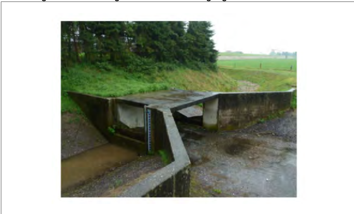
Afbeelding 5.11. Overstort grindfilters naar watergang Ameidse dam.
