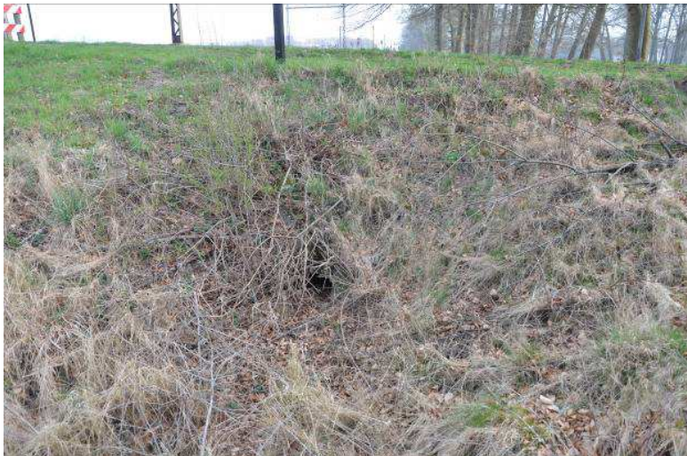
Figuur 4-5: niet (goed) functionerende dassentunnel ter hoogte van het spoor (Mertens, 2012)
