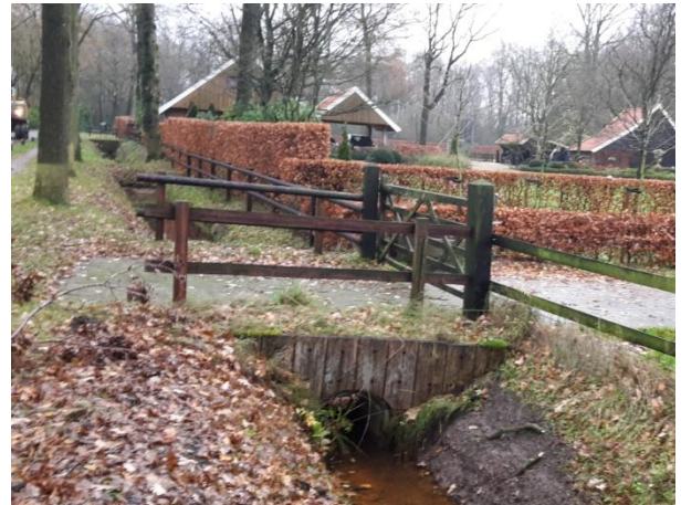
Foto 8: Kooiveldweg, de watergang ter plaatse van de Meekertweg 14 is gedeeltelijk overkluisd.
