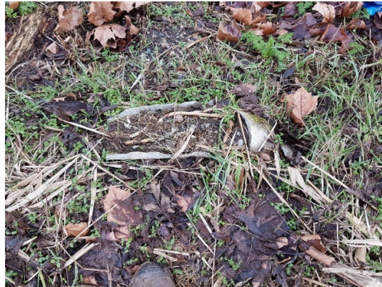
Foto 4: Gebroken asbestpijp buiten locatie
