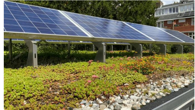
Zonnepanelen in combinatie met groen dak
