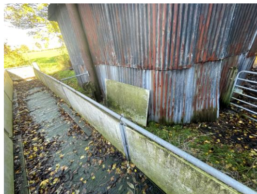
Stalschotten onderzocht (asbest aantoonbaar)
