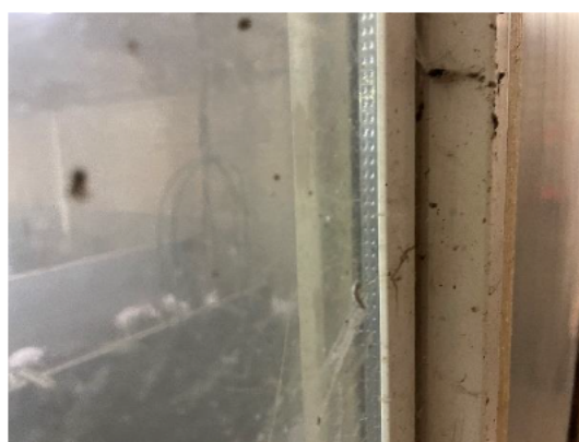
Afdichting in kozijnen opstal 4 (kit) niet verdacht
