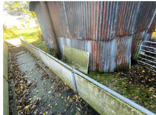
Stalschotten onderzocht (asbest aantoonbaar)
