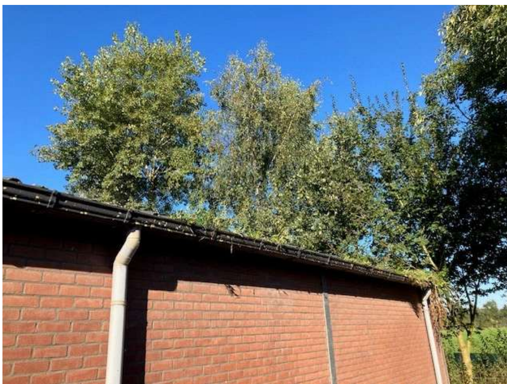
• Afbeelding 23: Zijgevel stal, veel grassen groeien in de dakgoot
