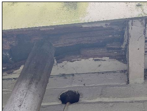
Figuur 5.6: gaten in het dakoverstek
