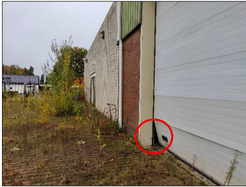
Opening waardoor een steenmarter de binnenkant van het gebouw kan bereiken.
