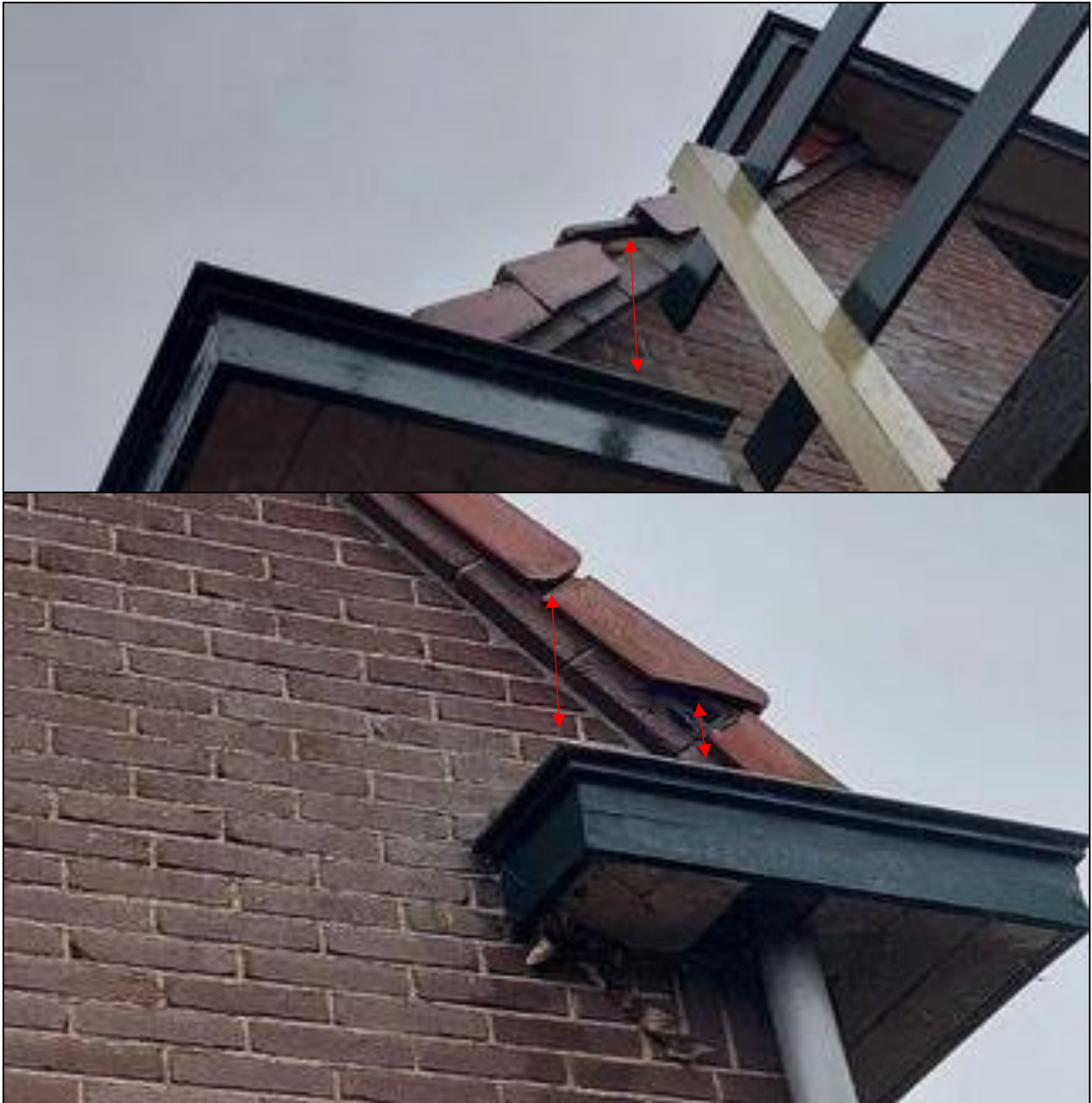
Figuur 6 | Geschikte locaties voor vogels zonder jaarrond beschermde nesten in gebouw – onder dakpannen, deze zijn ongeschikt voor vleermuizen en gierzwaluwen omdat er geen in- en uitvliegruimte is (<1 meter ruimte rode pijlen).
