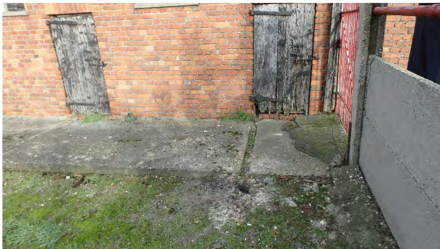
foto 3: boring 9 van vorig onderzoek, vertoonde sterke concentraties door verontreinigde afwatering afkomstig van de behandelde deur en verplaatst op zijn beurt via het gootje naar de bodem toe. (noordoostelijke richting)
