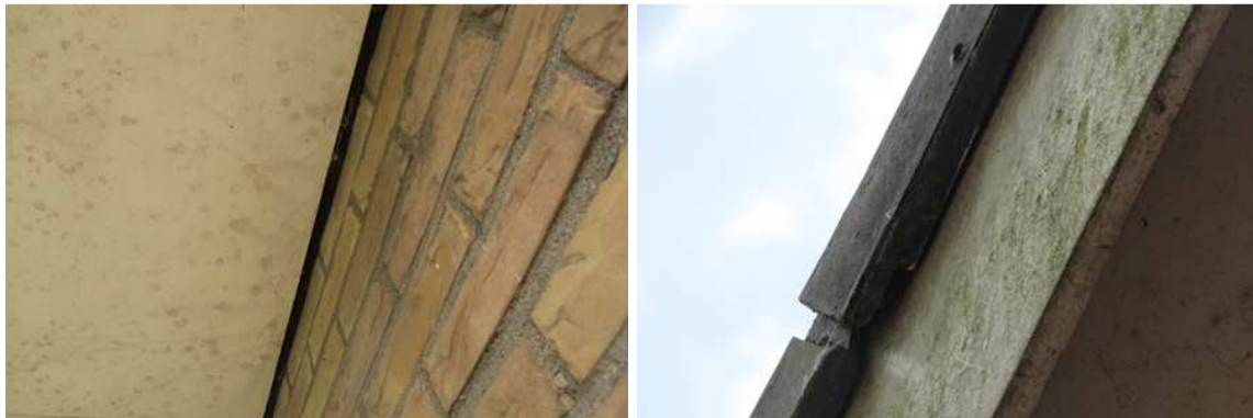
Nauw aansluitende betimmeringen en gevelpannen; deze bieden vleermuizen geen toegang tot het gebouw.
