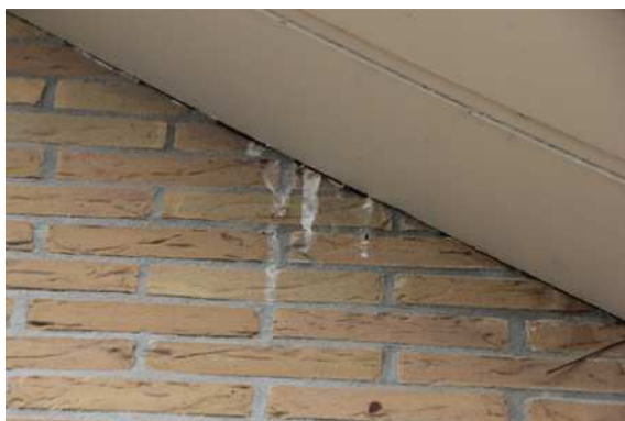
Schijfstreepen; indicatie voor een spreeuwennest onder de dakpannen.
