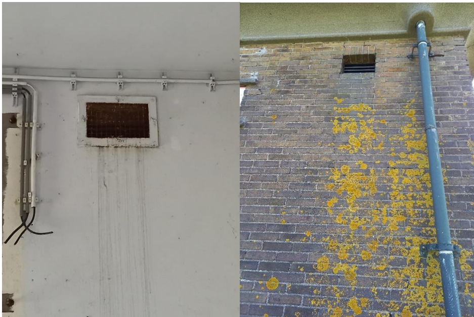
Binnen- en buitenzijde van ventilatieroosters in versterkerhuisje. (M. van Leeuwen, 23 juni 2022)
