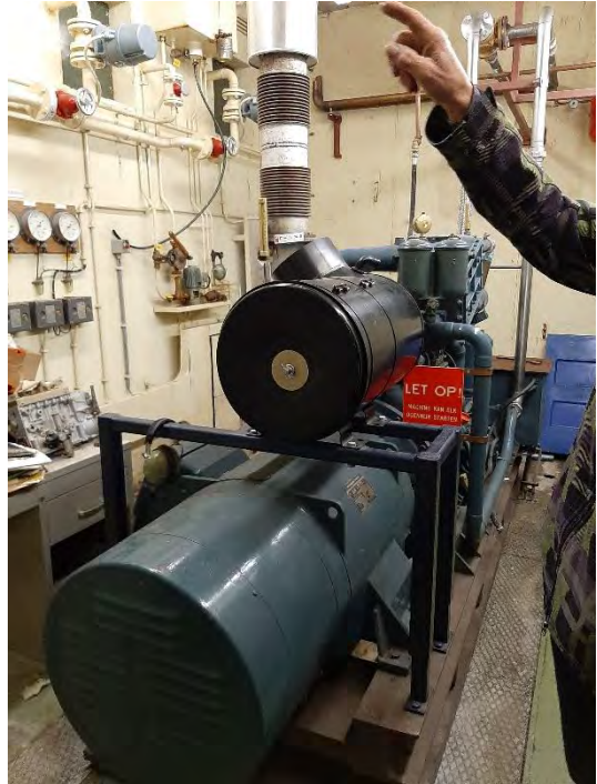
Foto 44 en 45: ruimte NSA in bunker, met oliegestookte generator
