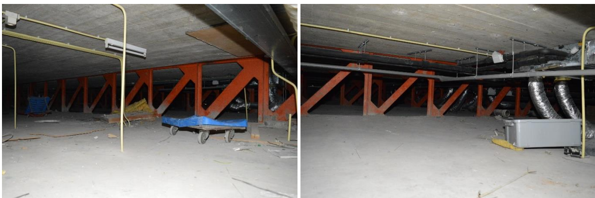
De leidingkoker tussen de machinezaal op de begane grond en de zenderzaal op de tweede verdieping. Hier vallen de vakwerkliggers van de staalconstructie te zien, tussen twee betonvloeren.
