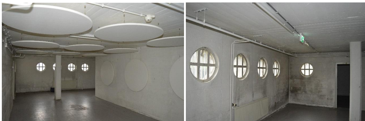
Links: overzicht van de bergingkelders onder het voorgebouw. Deze ruimten hebben een plavuizenvloer en wit beschilderde wanden en plafonds.
