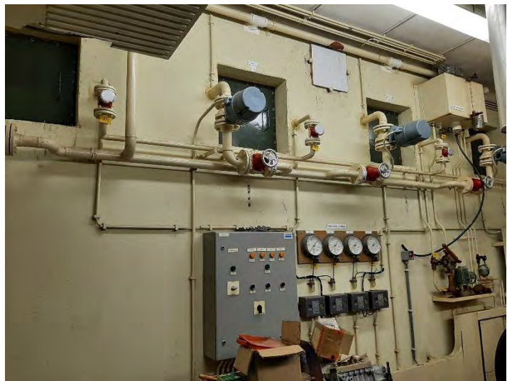
Foto 46: achter de groene luiken zijn de bovengrondse dieseltanks aanwezig
