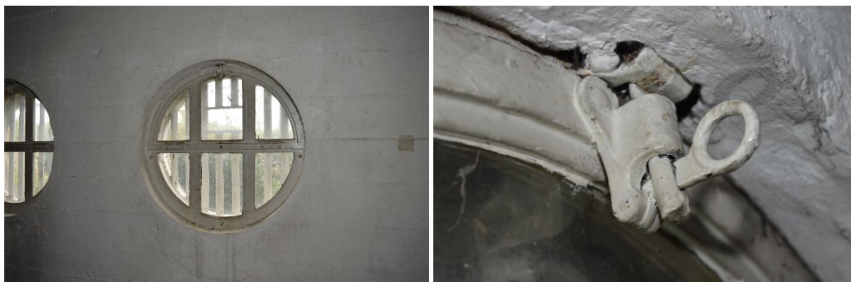
Links: een van de stalen rondvensters in de bergingkelder onder het voorgebouw. Het bovenste deel van het raam is te openen als valraam.
