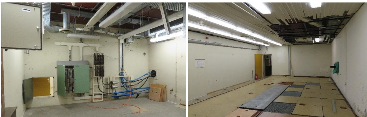
Links: een overzicht van ruimte 2, het voormalige versterkerstation. Het vluchtluik geeft toegang tot ruimte 1, de telefooncentrale. Ook hier is de interieur-afwerking gemoderniseerd.
