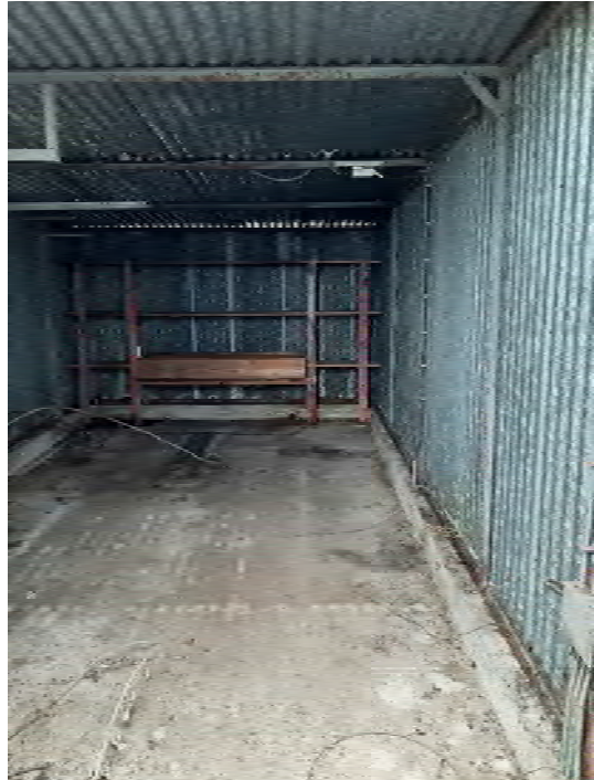
Foto 19: garagebox metaal (met verwarming)
