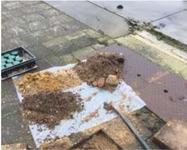
Foto 1, Boring gestuit op stukken baksteen
