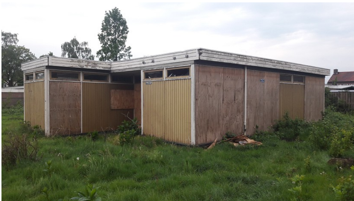
Vervallen bebouwing binnen het plangebied.
