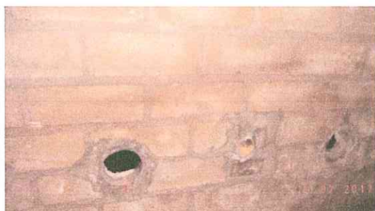
F11: C.v- ruimte / Locatie bron 3.1 verwijderd
