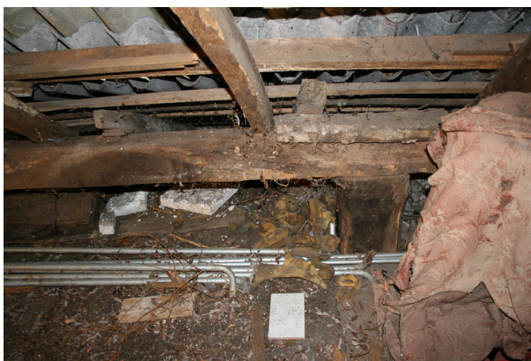
Gebintplaat op zolder
