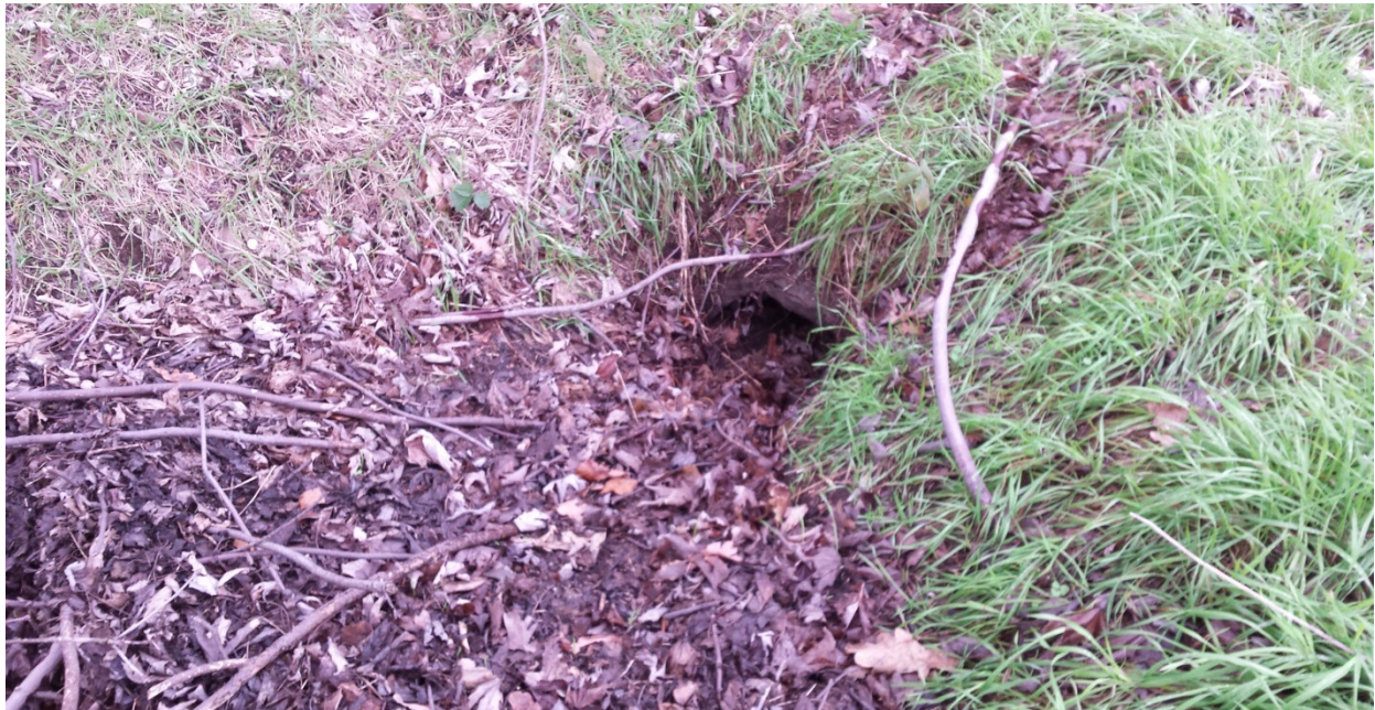
Figuur 3.2: De aangetroffen dassenburcht in een bestaande duiker aan de zuidwestrand van de bestaande bosschage.
