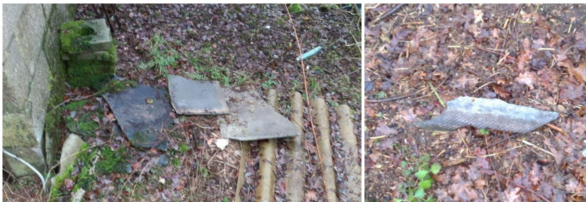
foto's: aangetroffen stukken asbest
