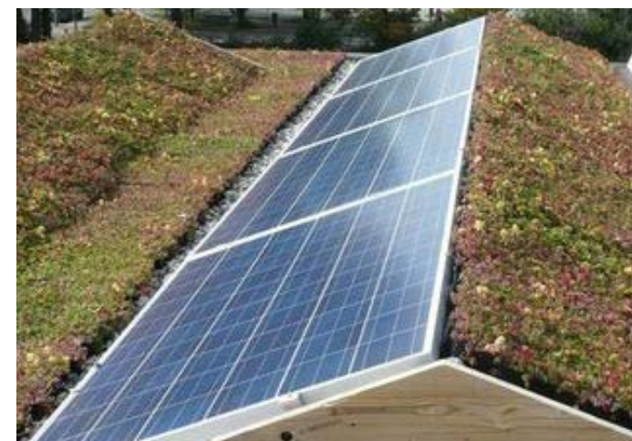
Zonnepanelen gecombineerd met sedumdak
