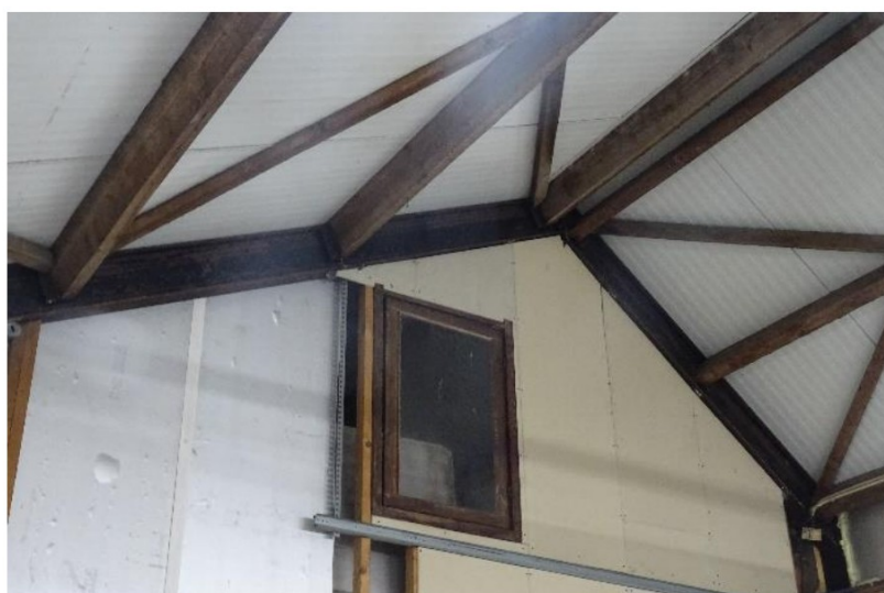
Afbeelding 7: geïsoleerde sandwichpanelen zonder mogelijke vaste rust- en verblijfplaatsen van vleermuizen. Bron: BNL advies. Datum: 28-03-2022
