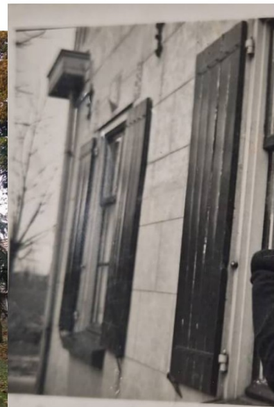
De eertijds uit de gevel stekende bakgoot boven de console.
