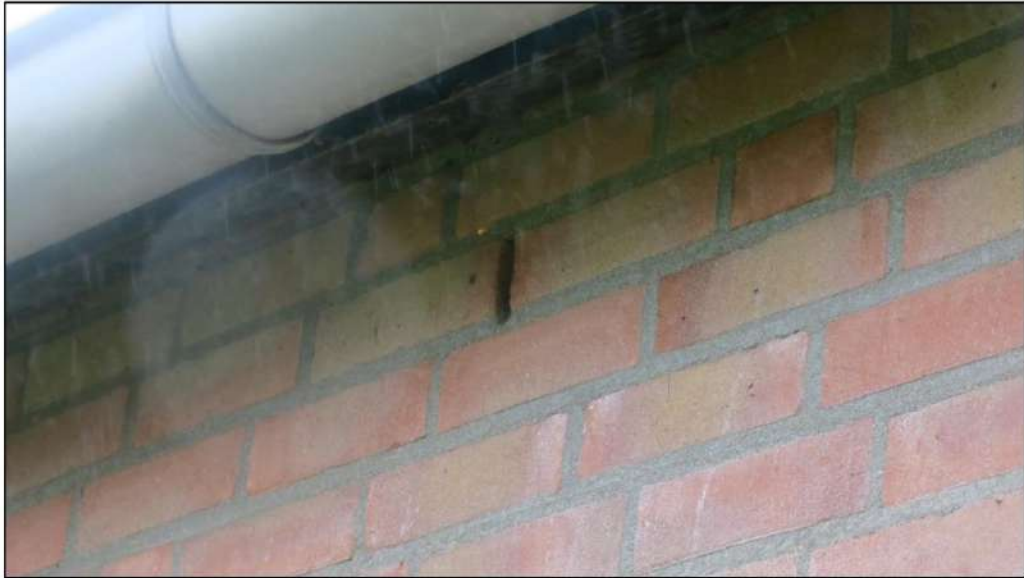
Figuur 3 In een van de stootvoegen is een wespennest aanwezig. Dit kan betekenen dat er genoeg ruimte kan zijn voor vleermuizen in de spouwmuur.
