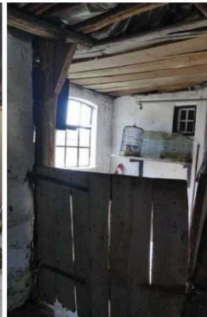
Afgescheiden ruimte waarin bevestiging voor de pomp van de melkmachine naast venster van knechtenkamer.
