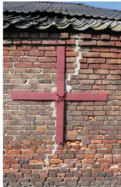
Anker in zuid-oostgevel.
