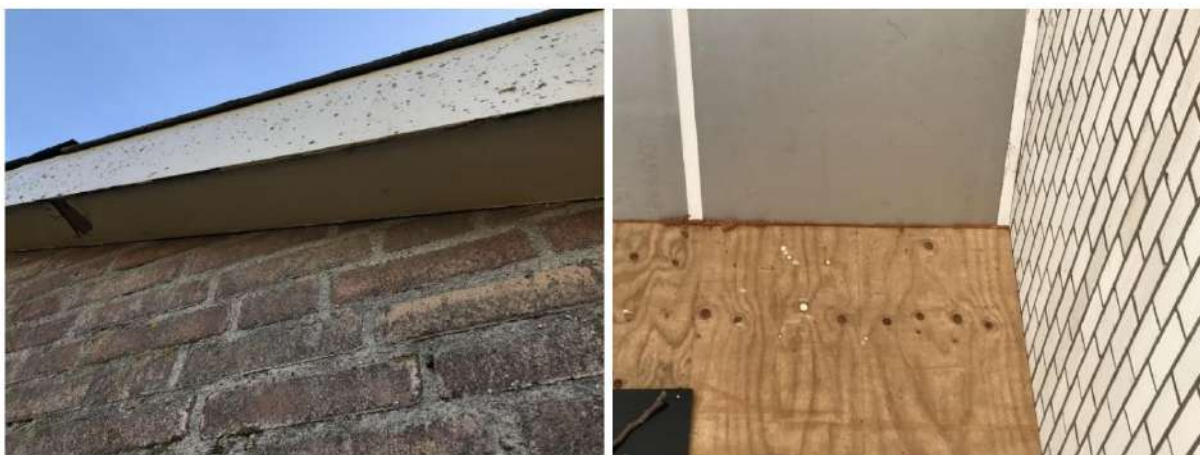
Afbeelding 9 en 10: Overstek goed aansluitend aan buitenmuur en kieren goed afgesloten met porschuim. Bron: [REDACTED]
