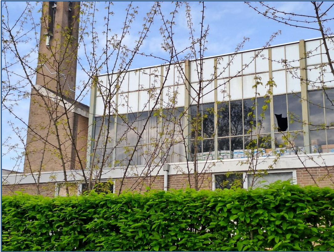
Zicht op gebroken raam in de oostgevel van de oostgevel van de voormalige kerk.
