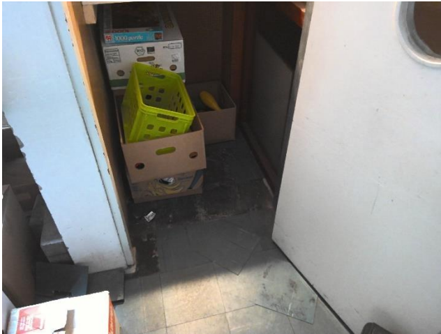
Piusplein 115: Foto 17 | Foto voor bron Bitumineuze lijmlaag
