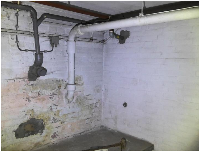
Piusplein 113: Foto 60 | Foto voor bron Buis / pijp
