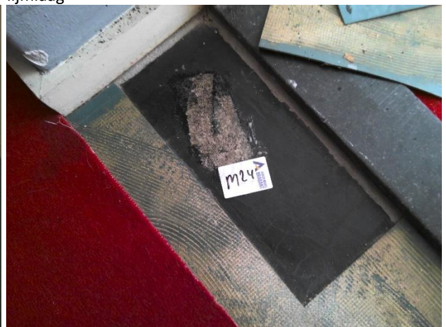
Piusplein 113: Foto 8 | Foto voor bron Bitumineuze lijmlaag
