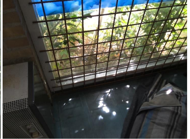
Piusplein 115: Foto 43 | Foto voor bron Beglazingskit
