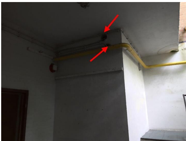
Piusplein 115: Foto 56 | Foto voor bron Buis / pijp
