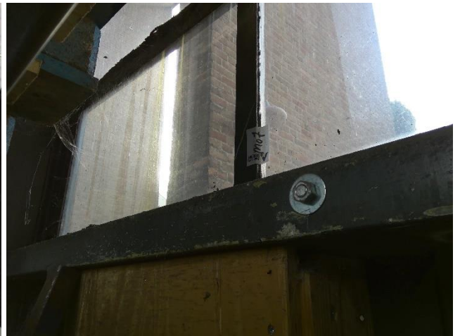
Piusplein 115: Foto 32 | Foto voor bron Beglazingskit
