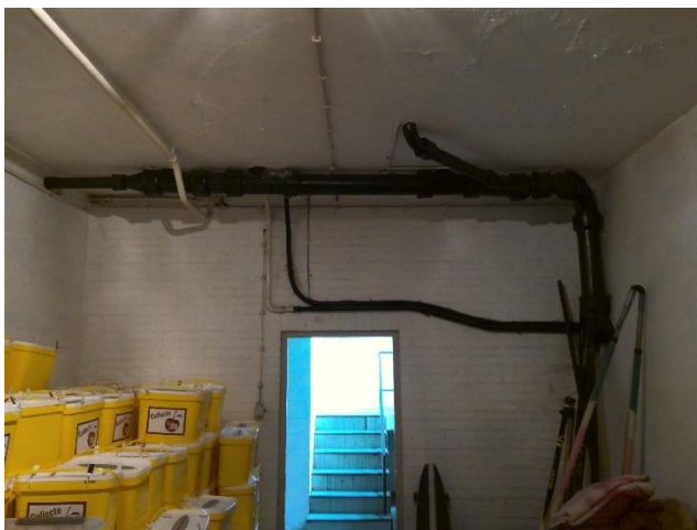
Piusplein 115: Foto 58 | Foto voor bron Buis / pijp
