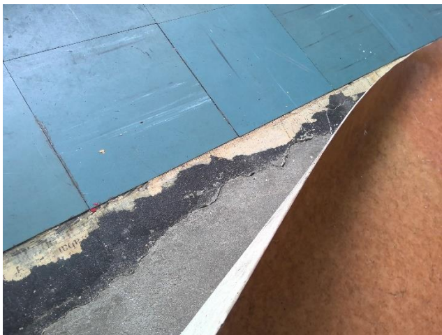
Piusplein 113: Foto 1 | Foto voor bron Bitumineuze lijmlaag
