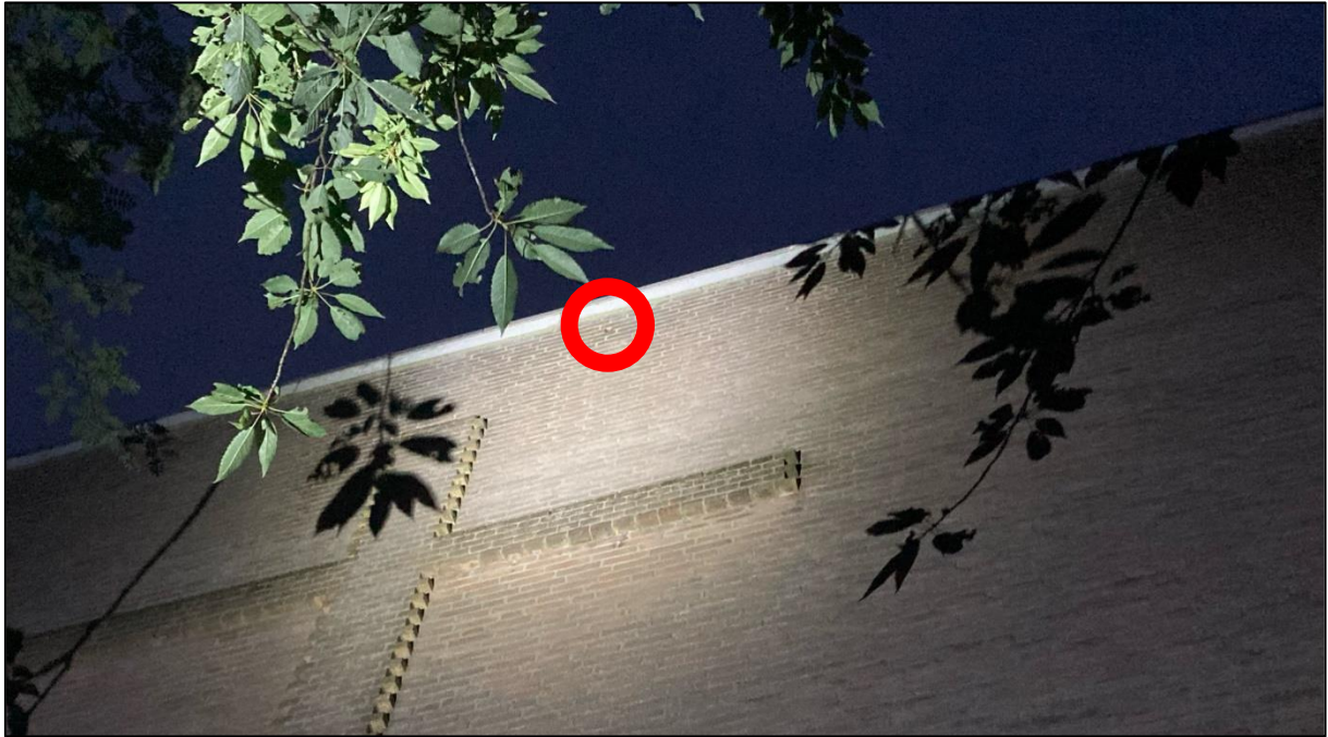
Foto 4. Stootvoeg als toegang tot zomerverblijfplaats van laatvlieger aan noordzijde van kerkgebouw.
