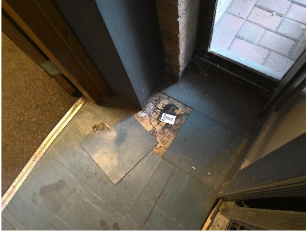
Piusplein 115: Foto 9 | Foto voor bron Bitumineuze lijmlaag
