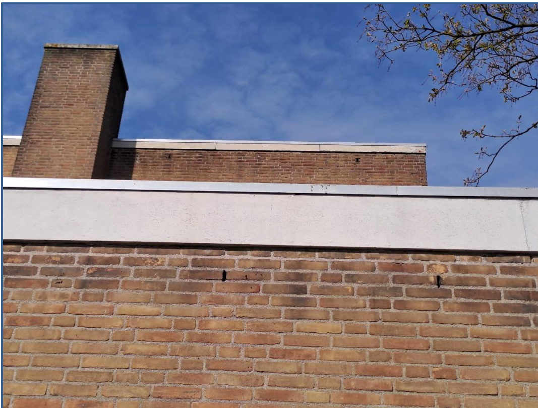
Oostgevel van de oude woningen (onder) en de voormalige kerk (boven), met stootvoegen.
