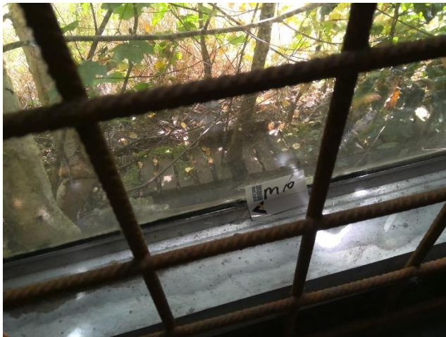
Piusplein 115: Foto 44 | Foto voor bron Beglazingskit
