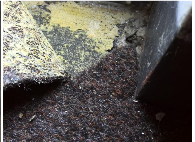
Piusplein 115: Foto 12 | Foto voor bron Bitumineuze lijmlaag
