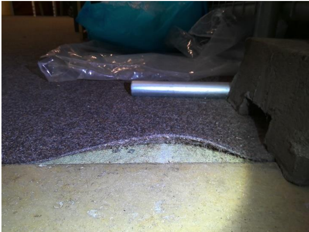
Piusplein 115: Foto 11 | Foto voor bron Bitumineuze lijmlaag
