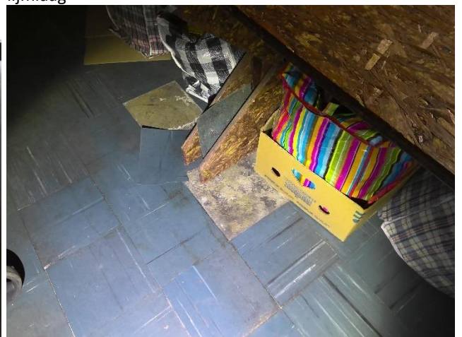
Piusplein 115: Foto 14 | Foto voor bron Bitumineuze lijmlaag
