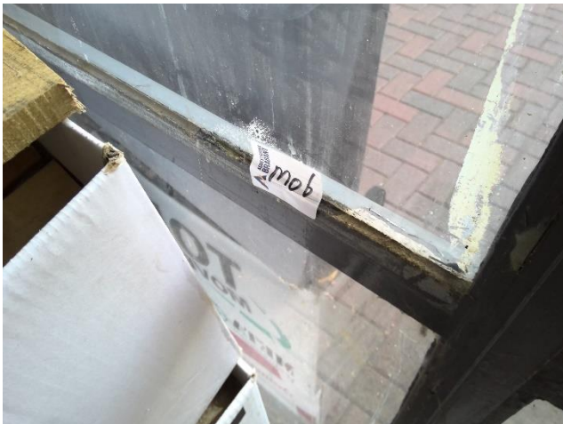
Piusplein 115: Foto 31 | Foto voor bron Beglazingskit
