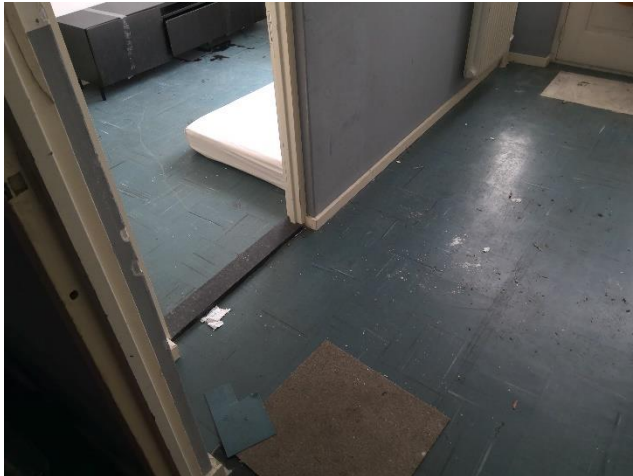
Piusplein 113: Foto 5 | Foto voor bron Bitumineuze lijmlaag
