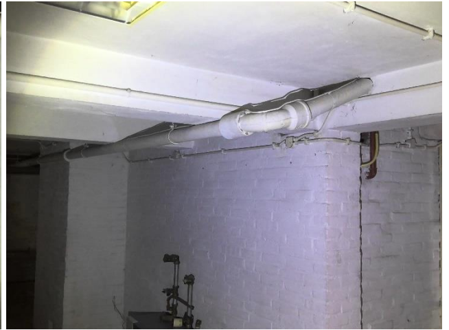
Piusplein 113: Foto 61 | Foto voor bron Buis / pijp
