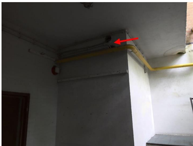
Piusplein 115: Foto 111 | Foto voor bron Buis / pijp
