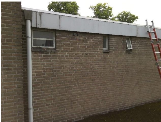
Piusplein 113: Foto 27 | Foto voor bron Beglazingskit
