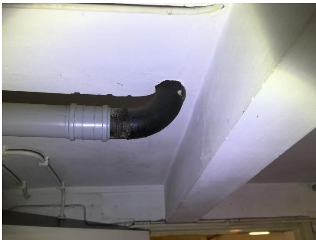
Piusplein 113: Foto 62 | Foto voor bron Buis / pijp
