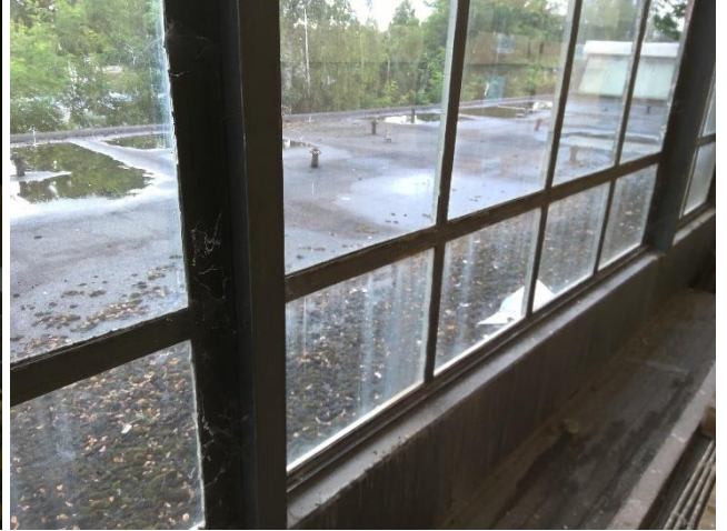
Piusplein 115: Foto 30 | Foto voor bron Beglazingskit
