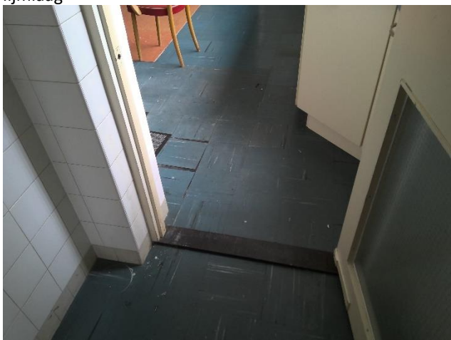
Piusplein 113: Foto 7 | Foto voor bron Bitumineuze lijmlaag
