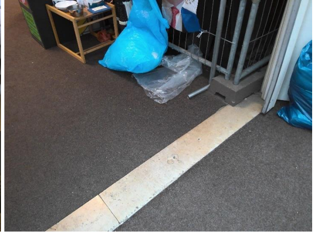
Piusplein 115: Foto 10 | Foto voor bron Bitumineuze lijmlaag
