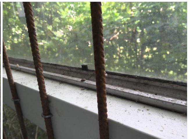
Piusplein 115: Foto 41 | Foto voor bron Beglazingskit
