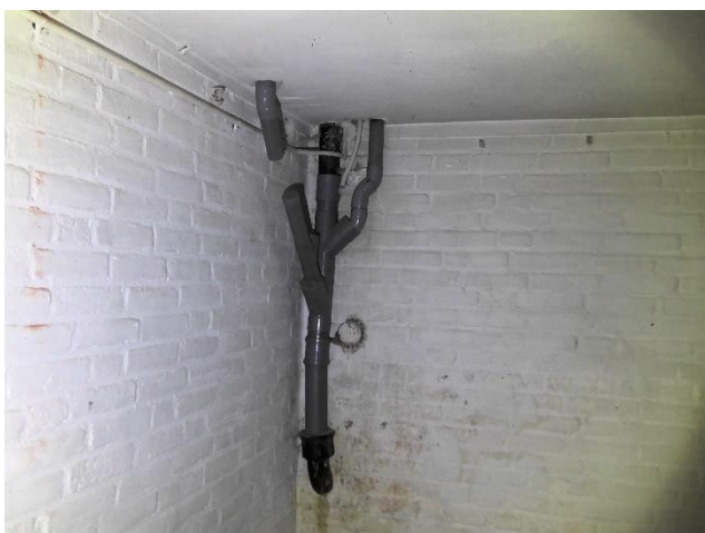
Piusplein 113: Foto 64 | Foto voor bron Buis / pijp
