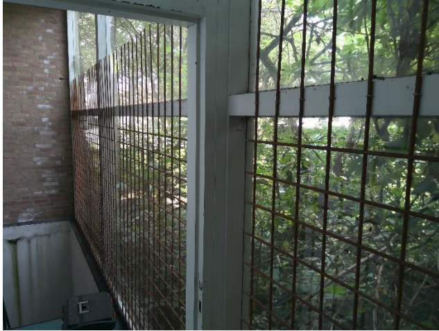
Piusplein 115: Foto 42 | Foto voor bron Beglazingskit
