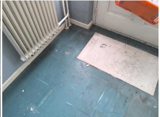
Piusplein 113: Foto 6 | Foto voor bron Bitumineuze lijmlaag
