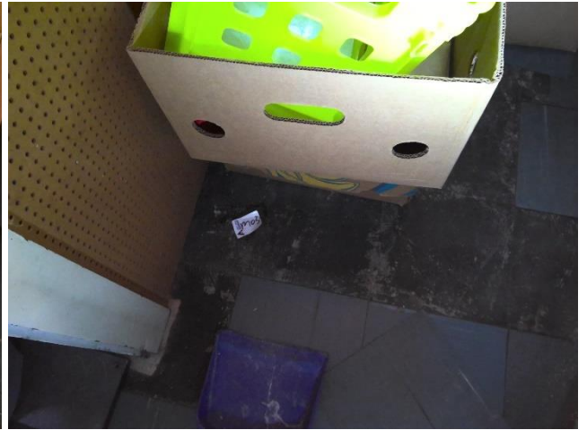
Piusplein 115: Foto 16 | Foto voor bron Bitumineuze lijmlaag
