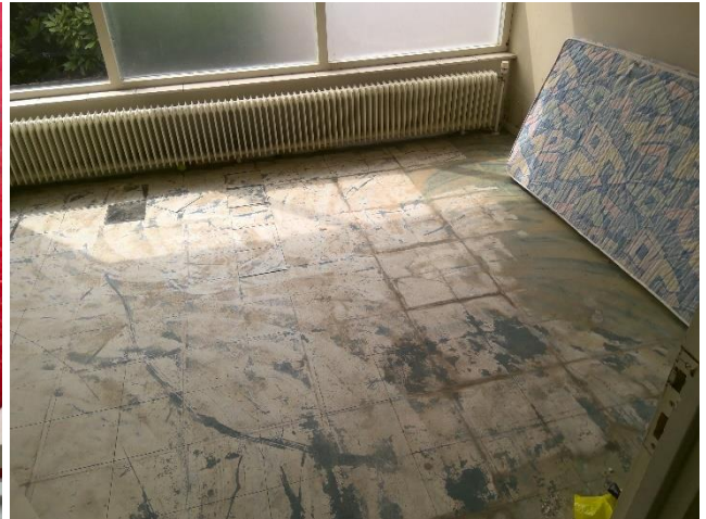
Piusplein 113: Foto 4 | Foto voor bron Bitumineuze lijmlaag
