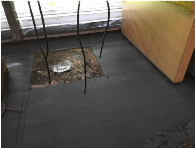
Piusplein 115: Foto 15 | Foto voor bron Bitumineuze lijmlaag
