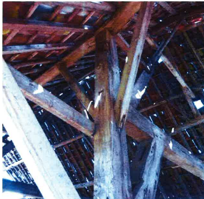
afbeelding 6. De gebintconstructie toont meerdere onbenutte pengaten en inkepingen.
