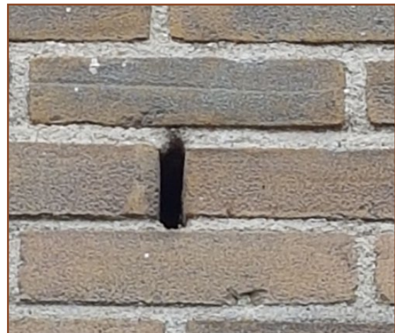
Afb. 2.3: Open stootvoeg in één van de zijgevels van de woning.
