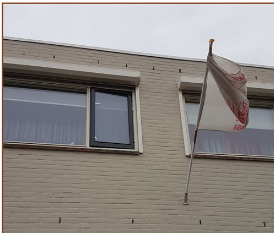
Afb. 2.2: Open stootvoegen in de voorgevel van de winkel en woning. Vleermuizen kunnen via de openingen de spouwruimte bereiken, nader onderzoek is noodzakelijk.
