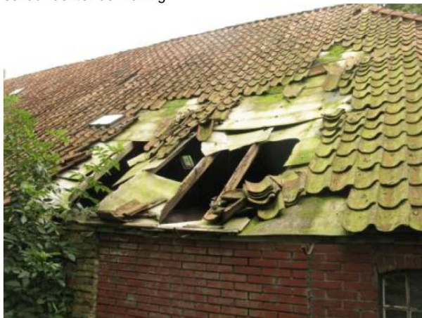
Foto 2: Het pannendak van de schuur is in slechte staat. Er is reeds sprake van een gat in het dak.
