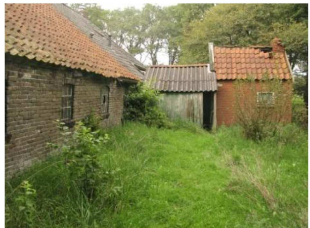
Foto 5: Vervallen bakhuisje met bijgebouwtje.
