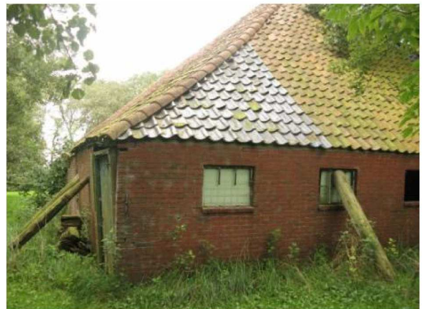
Foto 4: Hoek van de vervallen schuur
