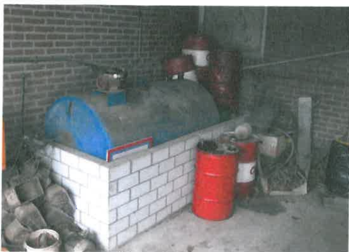
Foto 4: bovengrondse dieseltank (1.200 liter)
