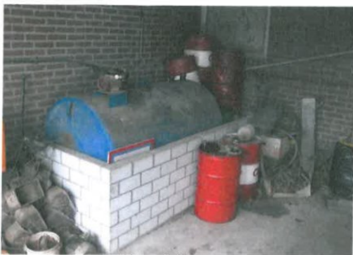
Foto 4: bovengrondse dieseltank (1.200 liter)
